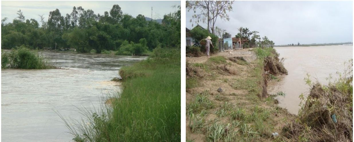
Hình 1.15. Sạt lở bờ tả khu vực nhà máy nước Hòa Thắng
